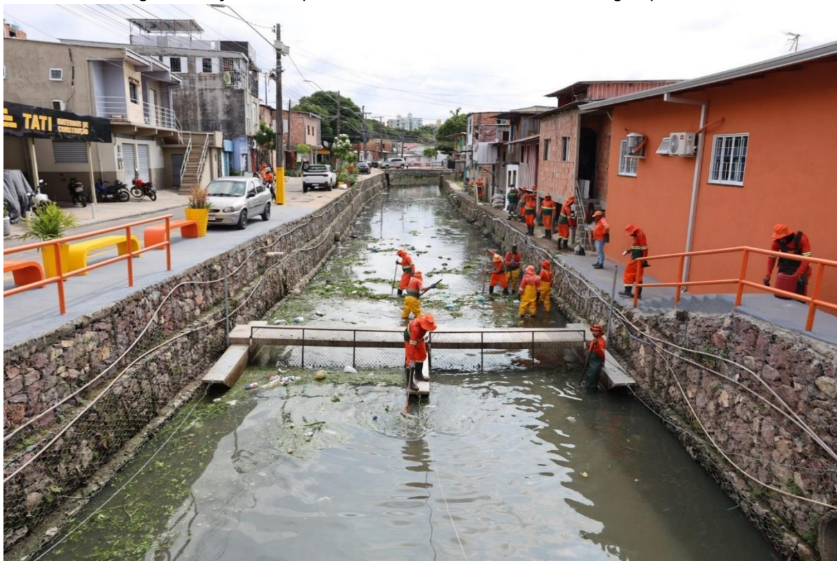
Figura 22 Ação de limpeza com a Ecobarreira instalada no Igarapé Bindá
