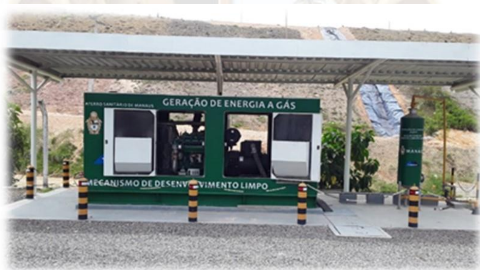
Figura 46 Gerador de Energia
