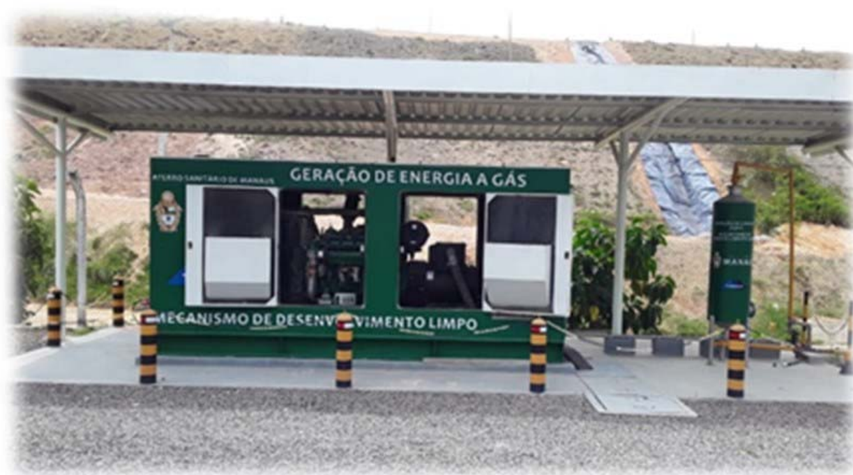
Figura 56 Gerador de Energia
