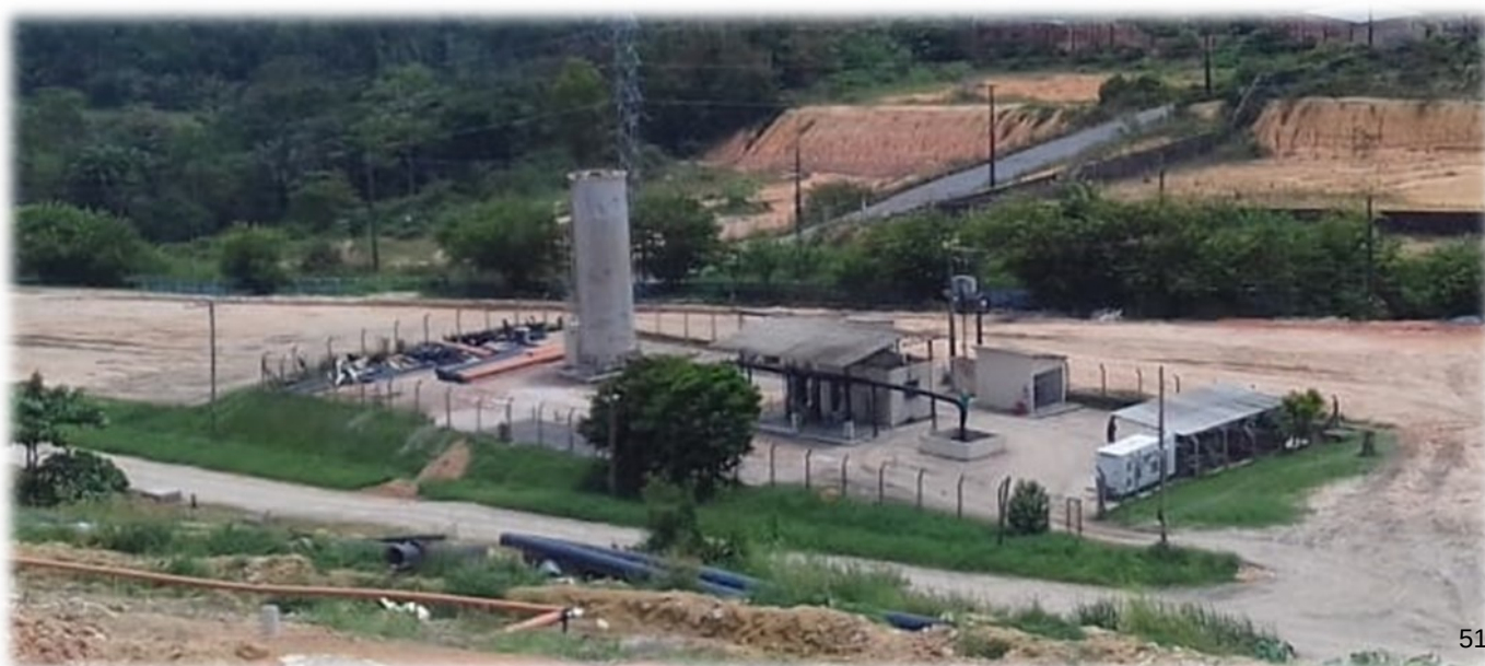
Figura 40: Vista Aérea da Planta da queima do Biogás
