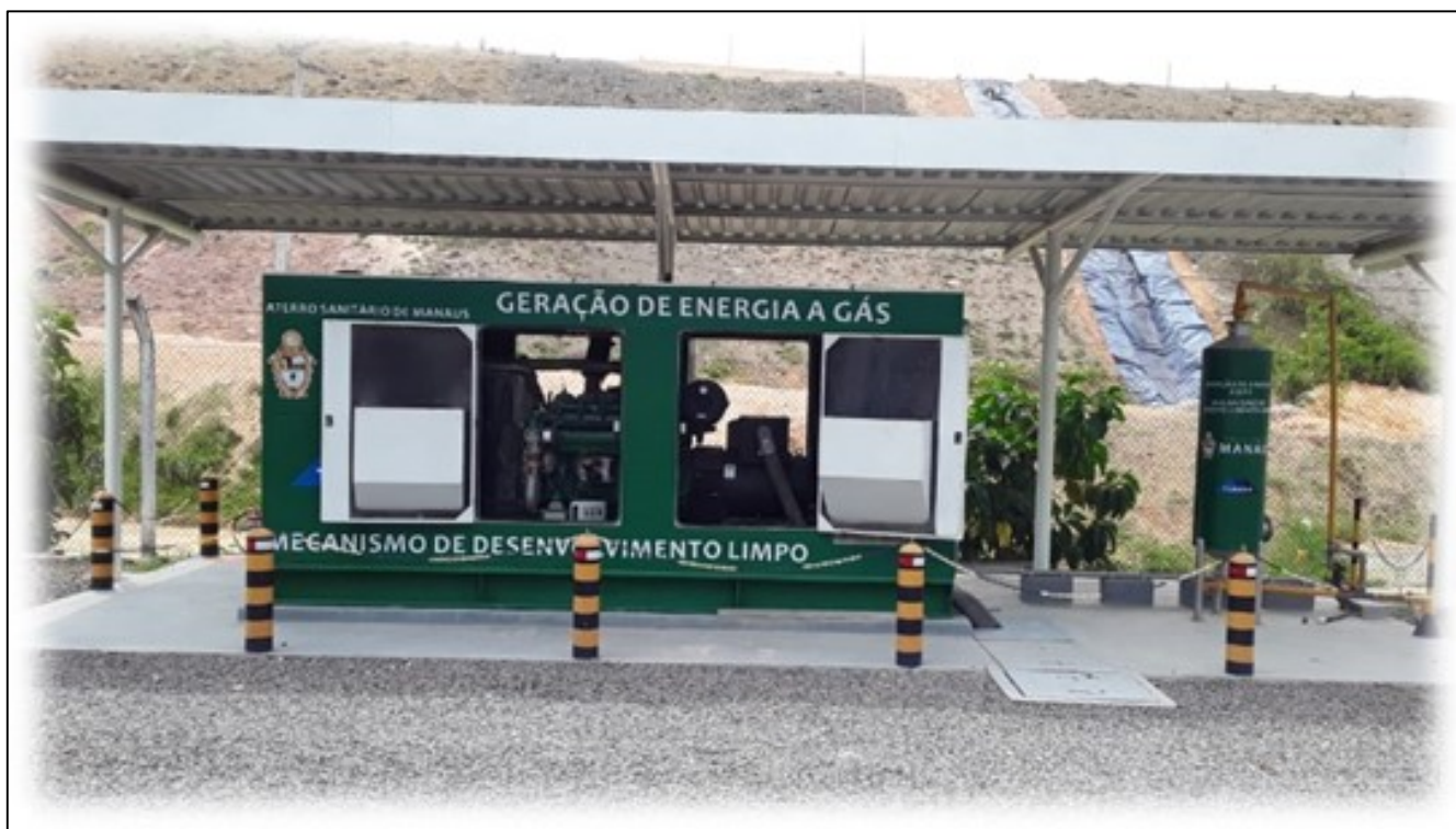
Figura 41: Gerador de energia do Biogás
