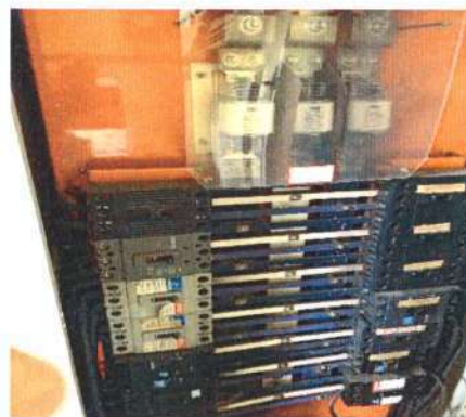
Quadro com os Barramento do Transformador de 225kva.
