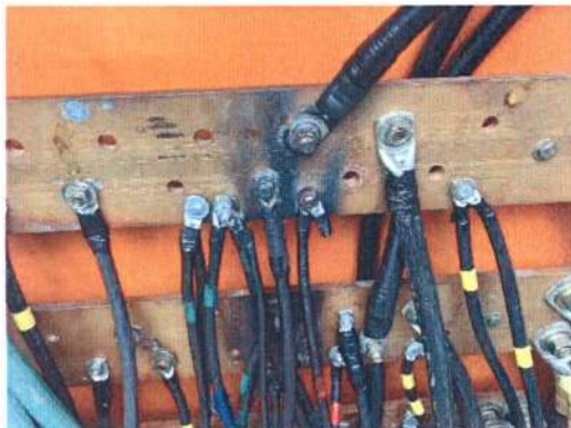
Quadro da Subestação com barramentos dos circuitos que alimentam os Quadros de distribuição.
