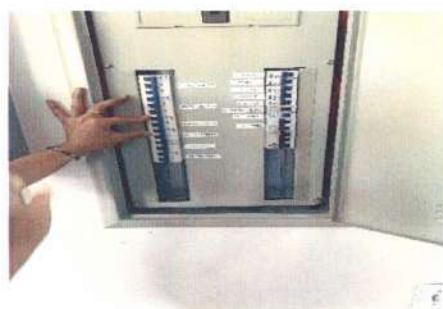
Quadro de distribuição do Núcleo de Saúde
