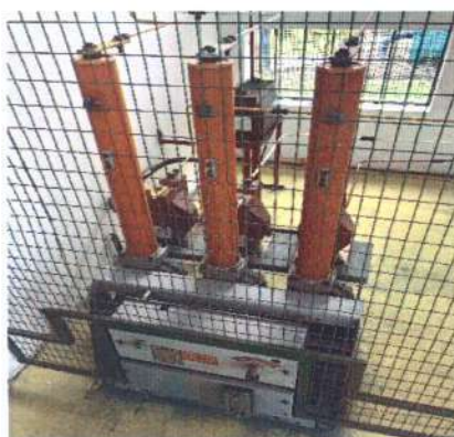
Logo atrás dos disjuntores de linha de média tensão está o Transformador de Potencial (TP).
