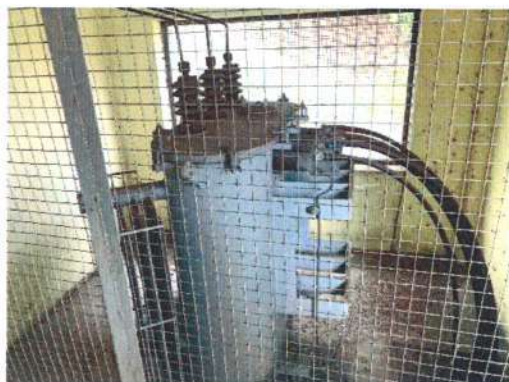
Transformador de 225kva do Parque do Idoso.
