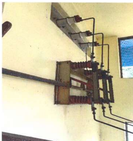
Chave seccionadora classe 15KV 100A.
