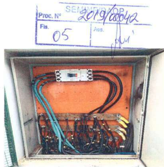
Quadro geral da Subestação.
